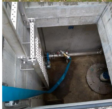
Abbildung 2: Anschluss im Schacht
