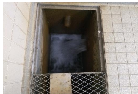
Abbildung 3: Ausspeisung freier Auslauf im Wasserwerk
