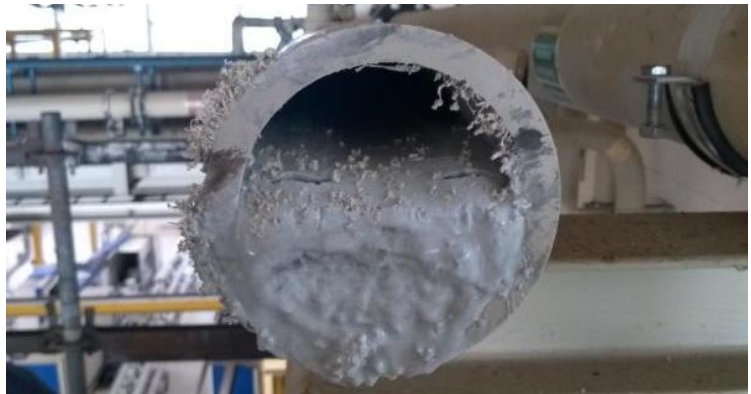
Abbildung 1: Ablagerungen in der Rohrleitung vor der Reinigung
