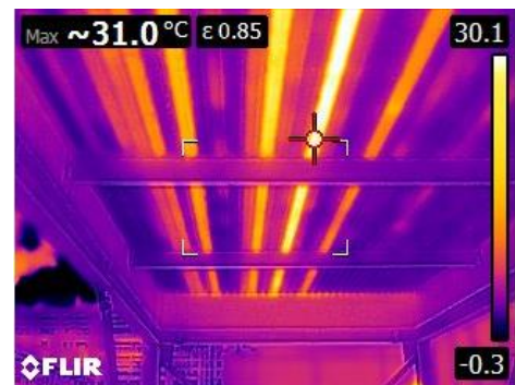
Abbildung 2: Wärmebild des Luftkühlers vor der Compress®-Reinigung
