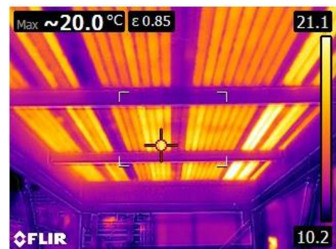
Abbildung 3: Wärmebild des Luftkühlers nach der Compress®-Reinigung
