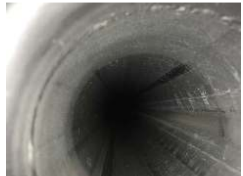
Abbildung 3: Rohrleitungsstück mit unvollständig ausgehärteten Ablagerungen nach der Reinigung
