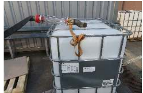
Abbildung 2: Ausspeisung von Spülwasser mit Ablagerungen in IBC
