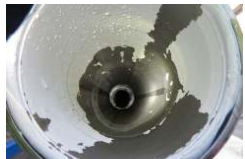
Abbildung 4: Rohrleitungsstück mit vollständig ausgehärteten Ablagerungen nach der Reinigung
