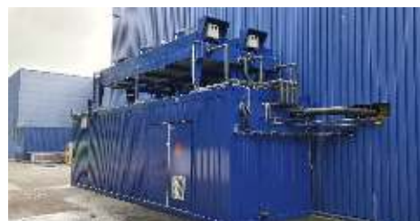
Abbildung 2: Neue Kälteanlage von L&R
