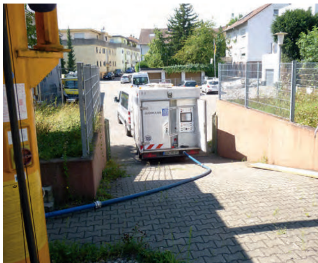
Abb. 1: Die technische Reinigungseinheit an der Pumpstation
