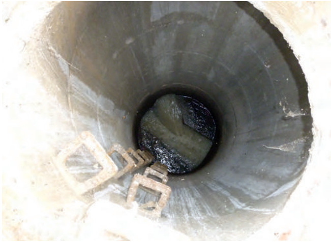
Abb. 4: Ausspeisung in einen Freispiegelkanal
