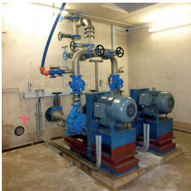
Abb. 2: Einspeisestelle über Pumpe
