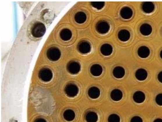
Abbildung 2: Zustand des Wärmeübertragers vor der Comprex®-Reinigung
