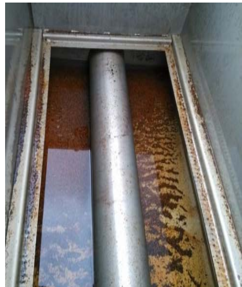
Abbildung 2: aus dem System ausgetragene Ablagerungen in Auslaufbox
