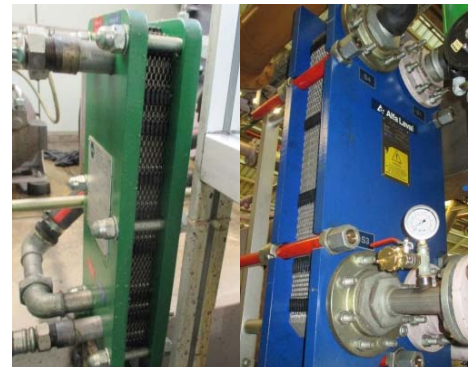
Abbildung 2: Plattenwärmeübertrager im Kühlsystem
