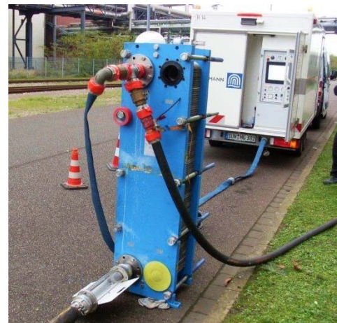
Abbildung 2: Aufbau für die Comprex®-Reinigung des Plattenwärmeübertragers in Fließrichtung
