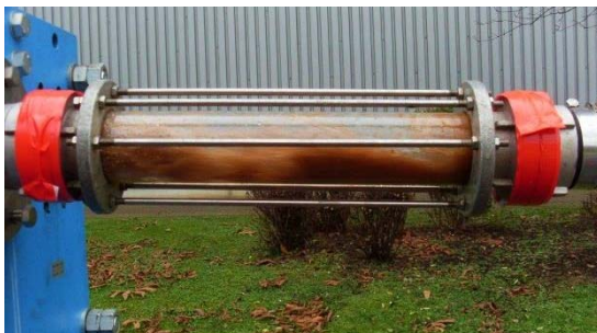
Abbildung 4: sichtbare Trübung im Schauglas während der Comprex®-Reinigung gegen die Fließrichtung
