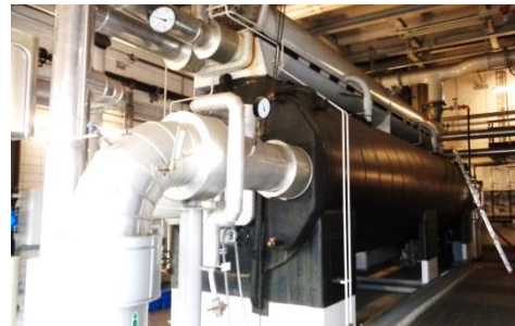
Abbildung 2: Absorber (Rohrbündelwärmetauscher) in Kältezentrale
