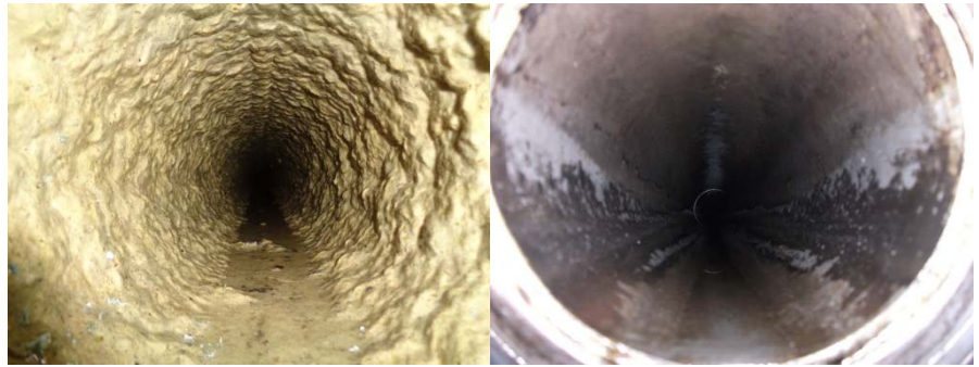
Abbildung 1: Zustand der Rohrleitung vor und nach der Comprex®-Reinigung
