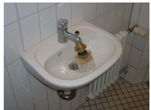
Abbildung 3: Ausspeisung an Waschbecken
