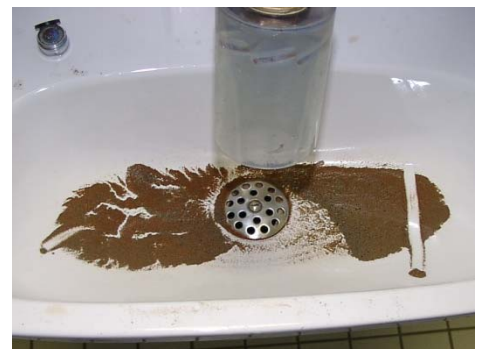
Abbildung 3: aus der Trinkwasser-Installation entfernte Partikel an Zapfstelle
