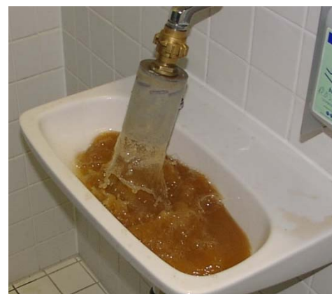
Abbildung 2: Trübung bei Ausspeisung über Waschbecken
