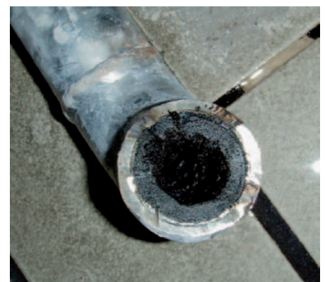
Bild 6: Manganschlamm in Rohrleitung aus nichtrostendem Stahl Fig. 6: Manganese sludge in a stainless steel pipeline
