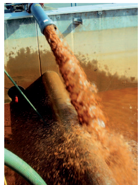
Bild 7: Eisenschlamm, Austrag aus Brunnenleitung während der Complex-Reinigung Fig. 7: Iron sludge, carried over from a well line, and following separation of flushing water
