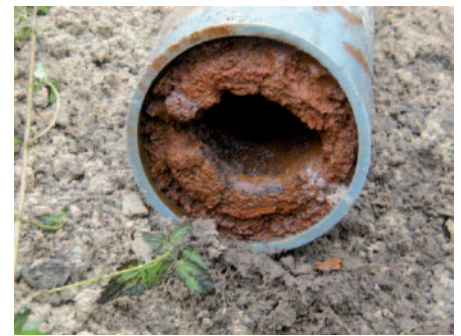
Bild 5: Eisenschlamm in Kunststoffrohrleitung Fig. 5: Iron sludge in a plastic pipeline
