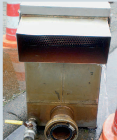
BILD 8: Funktionsprüfung der Schieber aufgrund Wasseraustritt am Auspeisehydranten: Schlecht schließende Schieber – erhöhter Wasseraustritt an Spülbox (oben); Gut schließende Schieber – wenig Wasseraustritt an Spülbox (unten)
