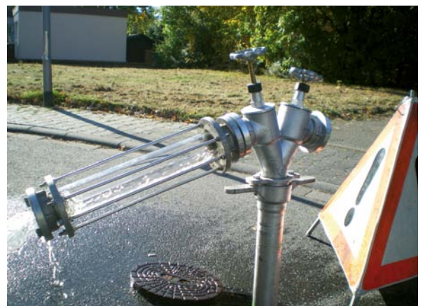
Bild 2: Wassermenge am Ausspeisehydranten zeigt die Schieberfunktion: erhöhter Wasseraustritt (oben) – schlecht schließend; geringer Wasseraustritt (unten) – ausreichend schließend
