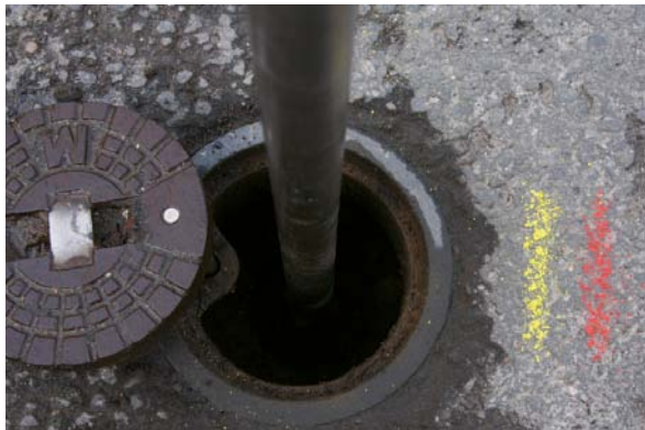
Bild 4: Kennzeichnung an Straßenkappe nach Überprüfung
