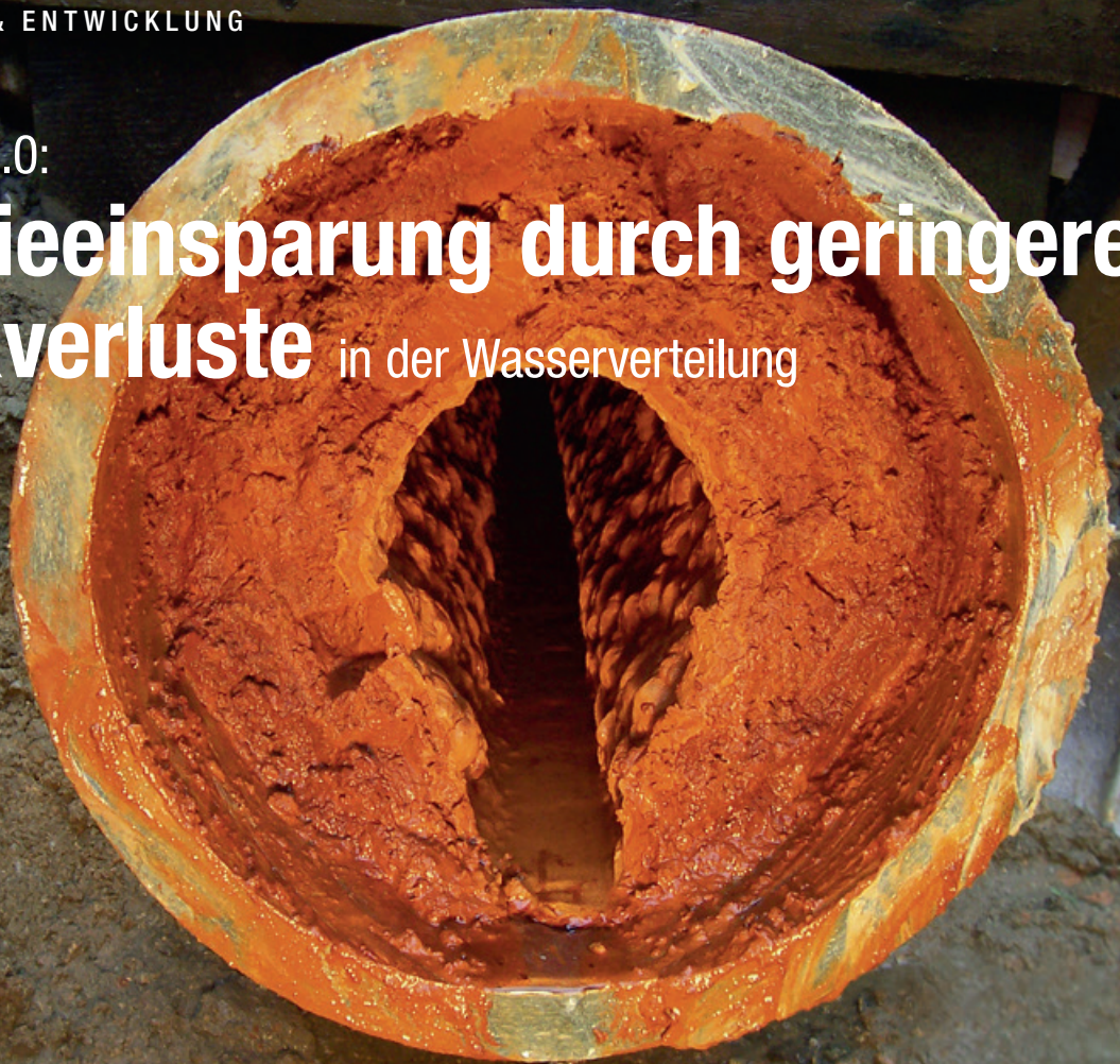
Querschnittsreduzierung einer Rohwasserleitung, bedingt durch Ablagerungen
