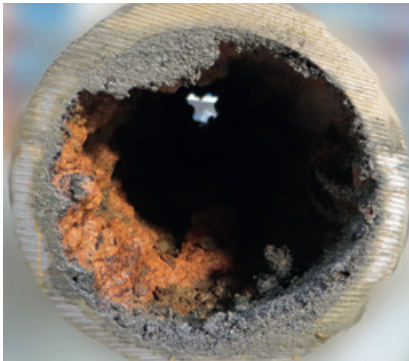
Abb. 4: Rohrstück mit reproduzierbaren Modellablagerungen (oben) sowie Rohrstück aus der Praxis mit Ablagerungen (unten)
