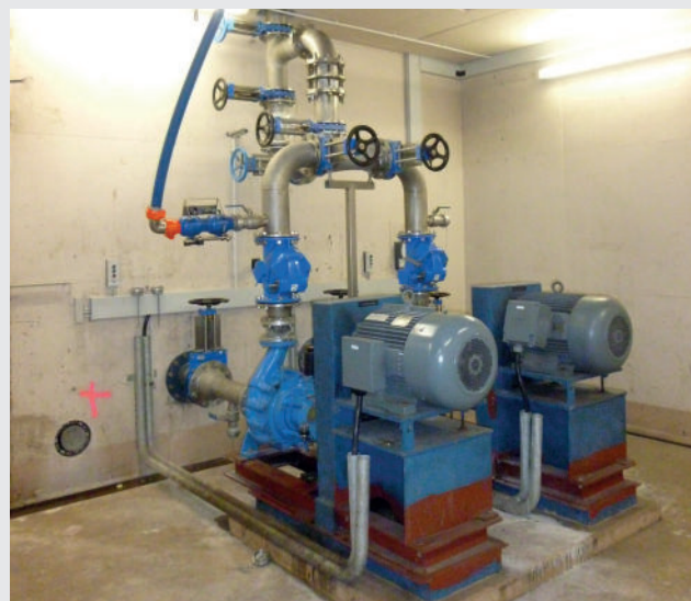
Bild 5: Einspeisestelle über Pumpe
