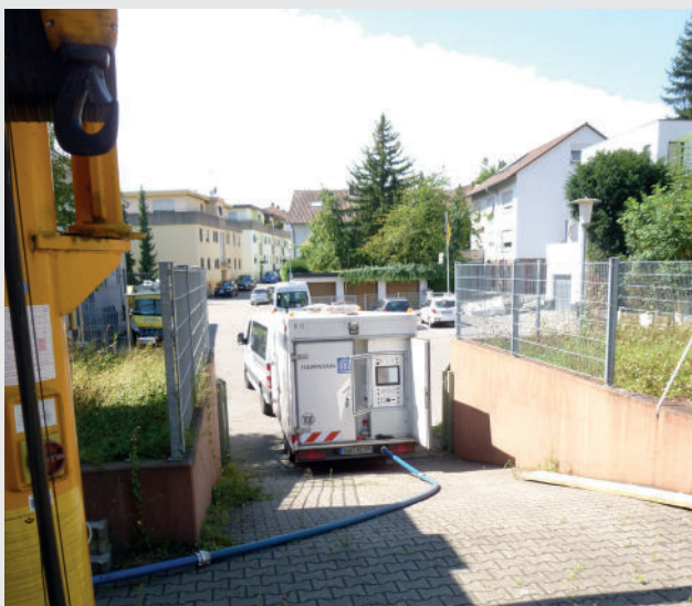
Bild 4: Complex-Einheit an Pumpwerk
