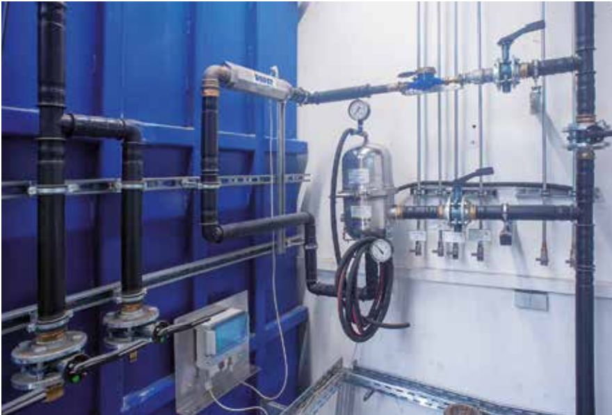
Das System zur physikalischen Wasserbehandlung (oben horizontal eingebaut) ist in den autarken Kühlkreislauf der Extrusionsanlage integriert.
