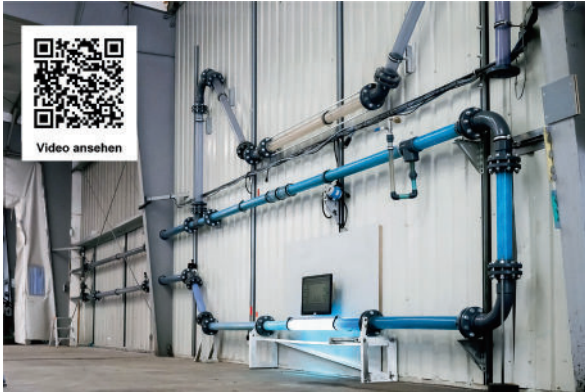
Abb. 7 // Teststrecke an der Versuchsanlage. Das Video hinter dem QR-Code vermittelt einen Eindruck von der Reinigungswirkung des Impulsspülverfahrens.
