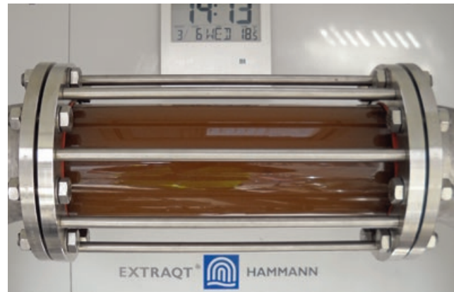
Abb. 5 – Trübung während der Wasser-Saug-Spülung als Indikator für Hotspots im Trinkwassernetz
