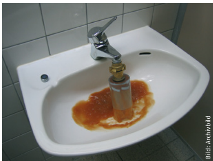
Zyclonabscheider an einer Entnahmestelle.
