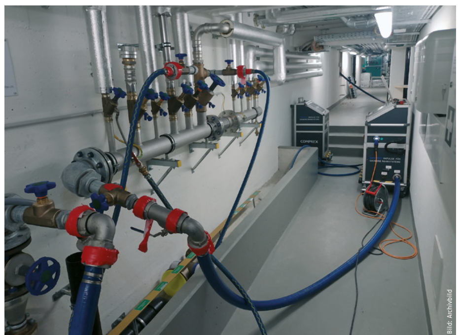
Mobile Complex-Einheit „MCU-TI“ mit Desinfektionsmodul MDM (Archivbild).
