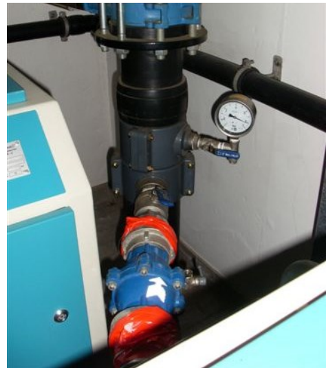
Abbildung 2: Einspeisung an Pumpwerk
