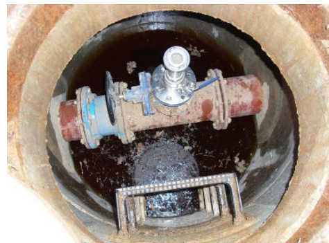
Abbildung 3: Einspeisung über Adapteranschlüsse an BEV
