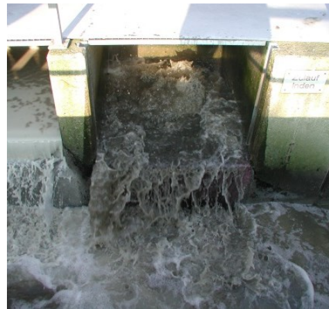
Abbildung 3: Ausspeisung in Klärwerk
