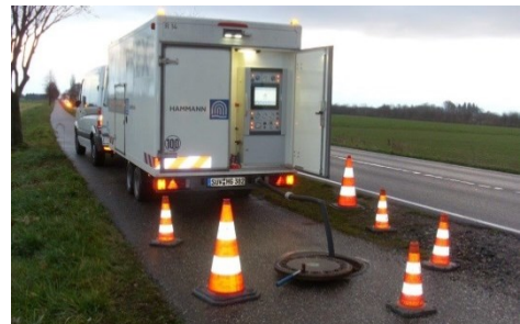
Abbildung 2: Einspeisung in Pumpwerk
