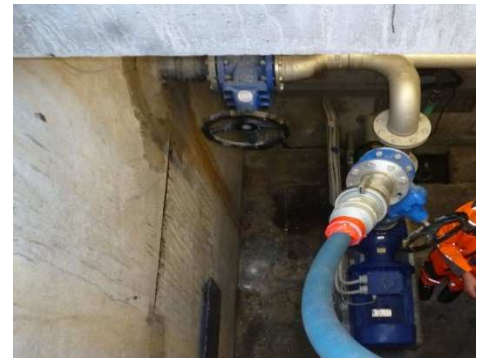
Abbildung 2: Einspeisung der Comprex®-Impulse im Pumpwerk
