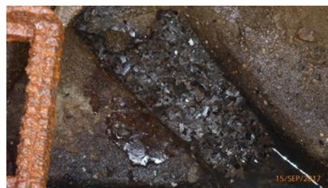
Abbildung 4: Ablagerungen in Schacht
