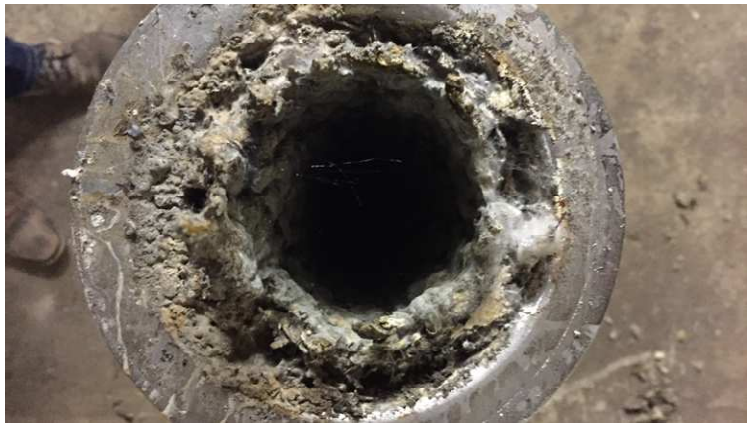
Abbildung 1: Primärschlammleitung vor der Comprex®-Reinigung
