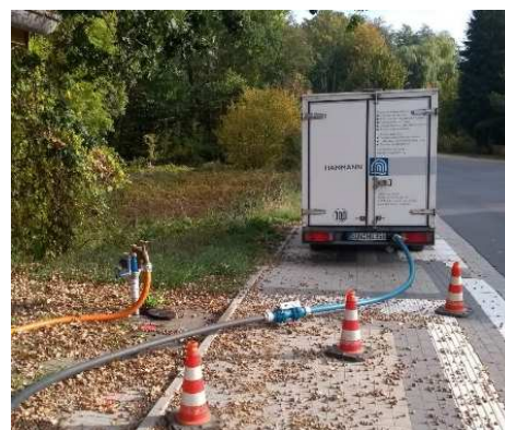
Abbildung 2: Comprex®-Einheit im Einsatz
