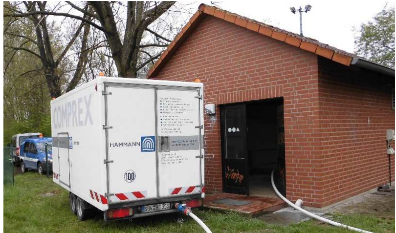
Abbildung 1: Comprex®-Einheit im Einsatz
