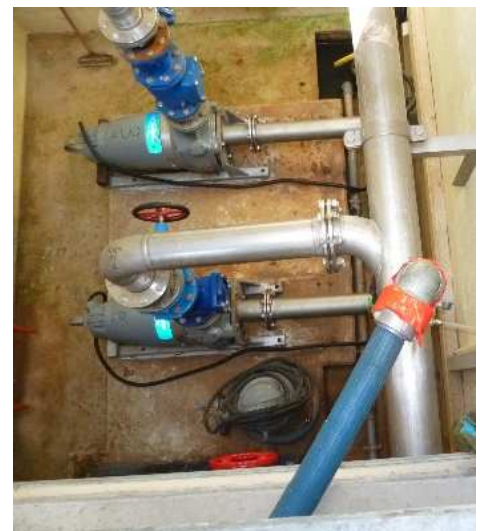
Abbildung 3: Anschluss am Pumpwerk
