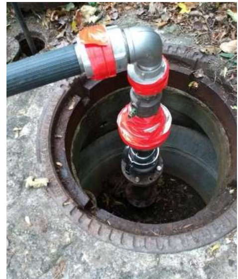
Abbildung 2: Einspeisung in Schacht
