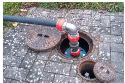
Abbildung 3: Einspeisung über Be- und Entlüfter (BEV)
