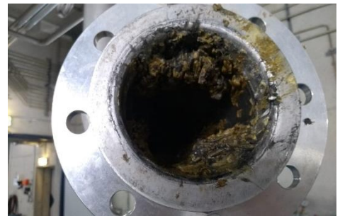
Abbildung 2: Überspeisepunkt Rohrende vor der Reinigung
