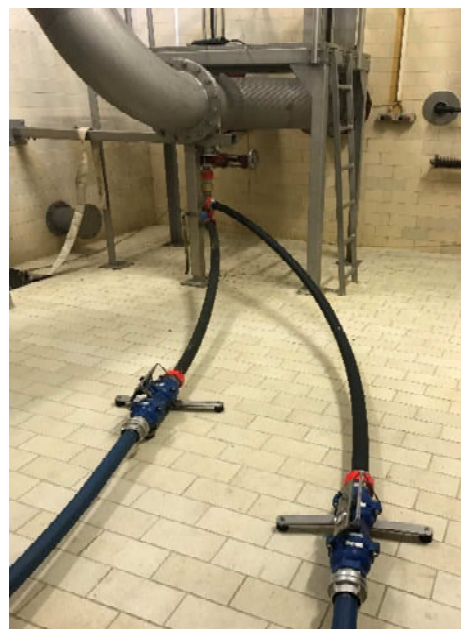
Abbildung 2: Einspeisung im Pumpwerk
