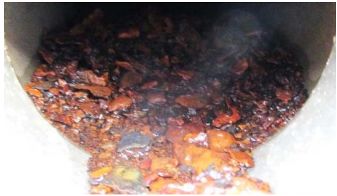
Abbildung 1: Aus dem System ausgetragene Ablagerungen
