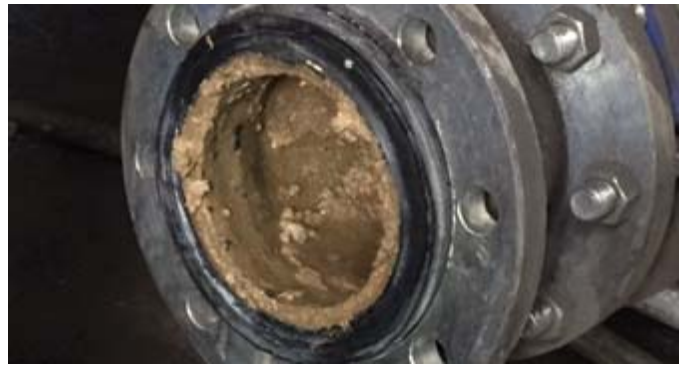
Ablagerungen in geöffnetem Flanschanschluss
