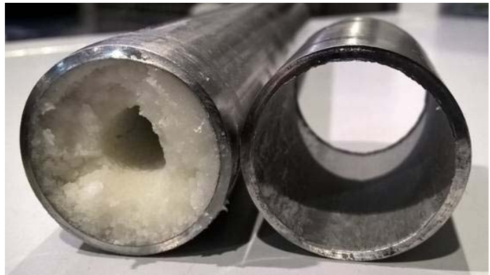
Abbildung 1: Rohrleitung für Kühlschmierstoff vor der Reinigung (links) sowie nach der Reinigung (rechts)
