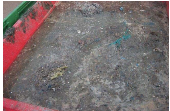
Abbildung 1: aus dem Wärmetauscher entfernte Verschmutzungen
