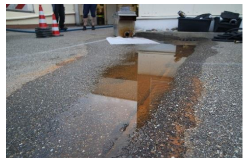
Abbildung 5: Ausgetragene Ablagerungen an der Ausspeisestelle
