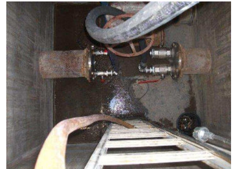
Abbildung 2: Einspeisung von Wasser und Luft in Schacht
