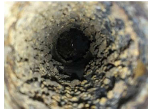
Abbildung 2: Ablagerungen vor der Reinigung
