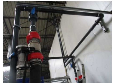
Abbildung 2: KSS-Rohrleitungen aus PVC
