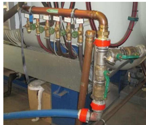
Abbildung 2: Anschlüsse am Vorlauf des Kühlkreislaufes
