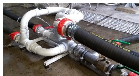
Abbildung 2: Verteiler zum gezielten Wechsel der Spülrichtung
