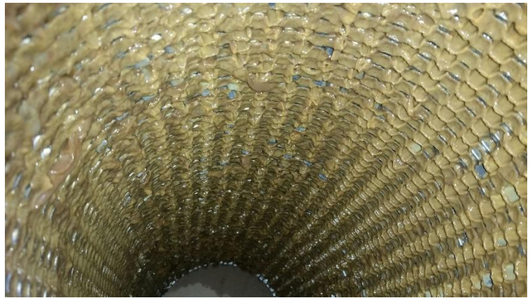
Abbildung 1: Ablagerungen im Wärmetauscher vor der Reinigung
