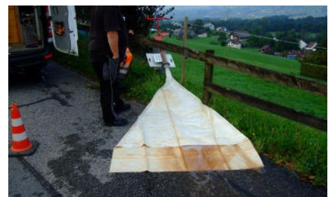
Abbildung 2: Spülsack an Ausspeisestelle
