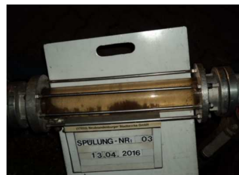
Abbildung 4: Schauglas an Ausspeisestelle
