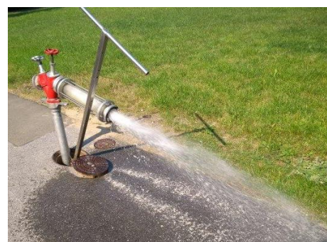
Abbildung 2: Ausspeisung über Hydranten
