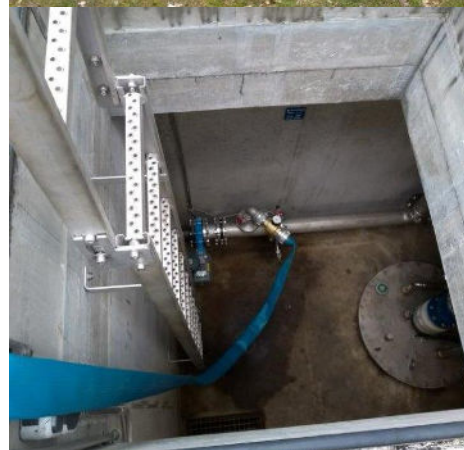
Abbildung 2: Anschluss im Schacht
